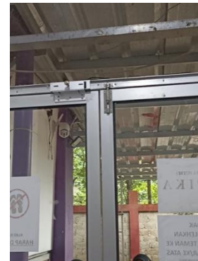
Gambar 27. Electromagnetic doorlock mengunci pintu
