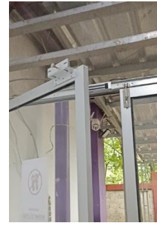
Gambar 26. Electromagnetic doorlock membuka pintu
