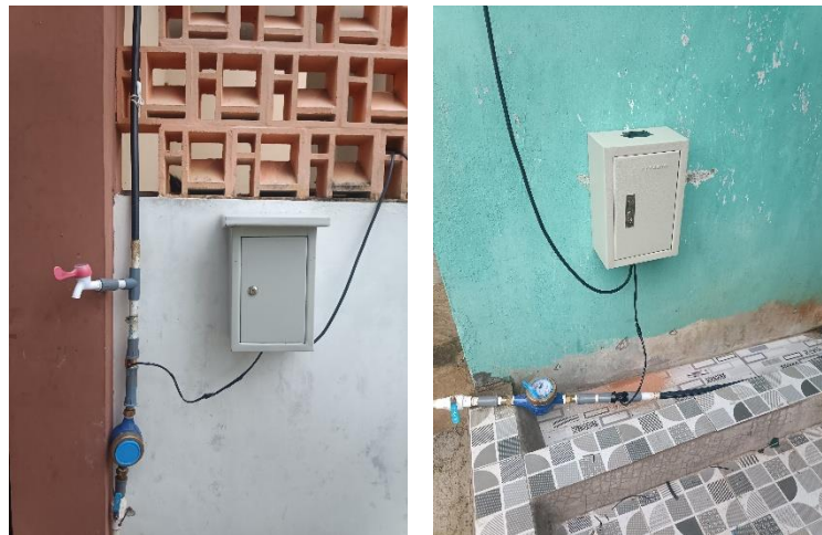
Gambar 5. Alat yang sudah terpasang
