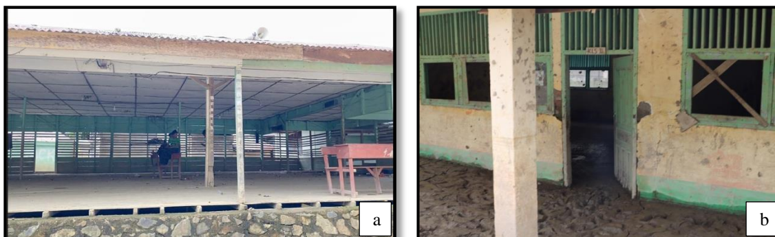
Gambar 1. Kondisi kerusakan fasilitas umum pascabanjir seperti (a) mushola di Desa Sigrun dan (b) SDN Jabi-Jabi Kecamatan Sultan Daulat Kota Subulussalam
